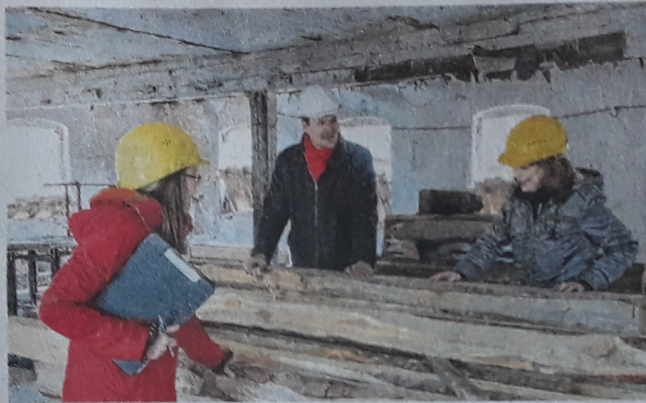
Friederike Böttcher, Adrian Rinnert und Kathrin Kagemann auf der Baustelle. Foto: ideengrün/M. Pichlmaier
